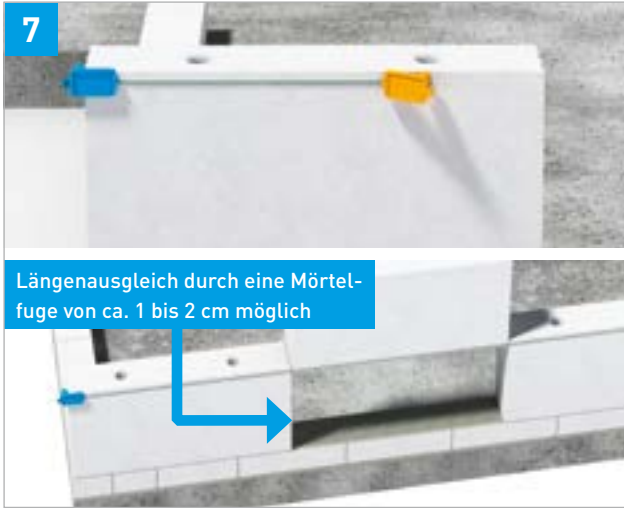
7 Steinschicht setzen (ggf. mit Schnurspanner als Hilfe) Fugen zum Toleranzausgleich im Bereich des Wandendes sind ungünstig.
