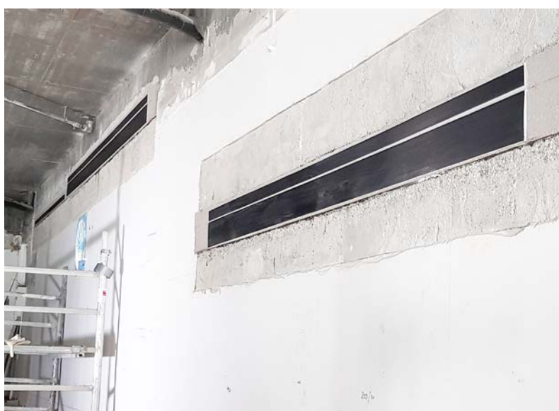
Kindertagesstätte, Offenbach, DE StoCretec-Kompetenzen: StoConcrete Carbon Plate, oberflächlich geklebt, StoPox Mörtel standfest
