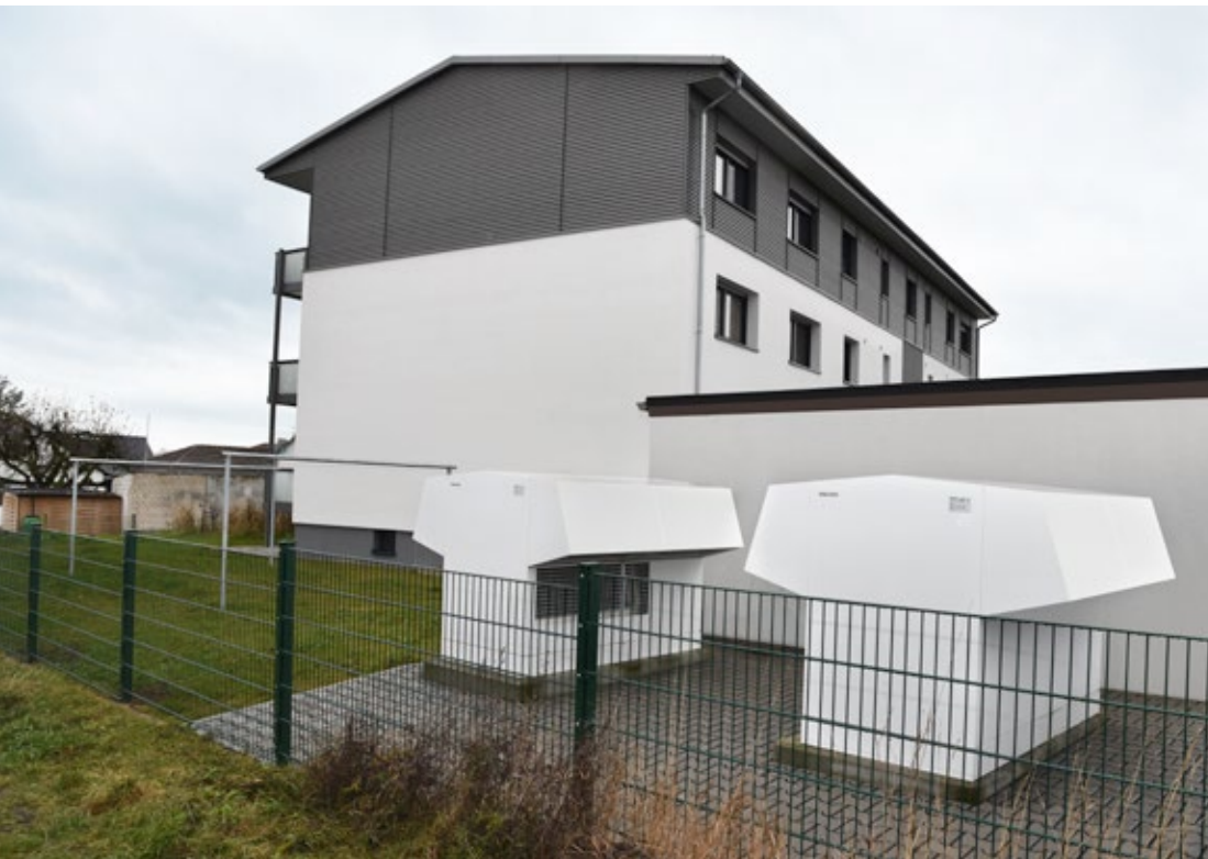
Neu neben dem Garagengebäude: die beiden Luft-Wasser-Wärmepumpen WPL 57 von STIEBEL ELTRON.
