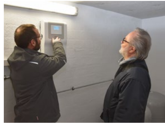
Installateur Kim Buttron (links) am Regler der Wärmepumpen-Kaskade, rechts Architekt Uwe Hartmann.
