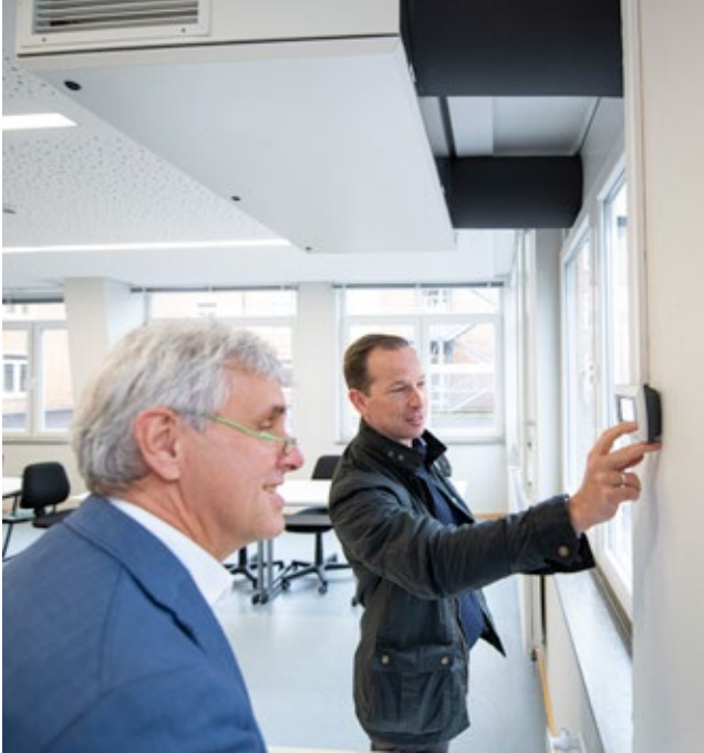
Mark Becker vom Installationsunternehmen Gebrüder Becker erläutert Schulleiter Andreas Hölzchen die Funktionen der Steuerung des Gerätes.
