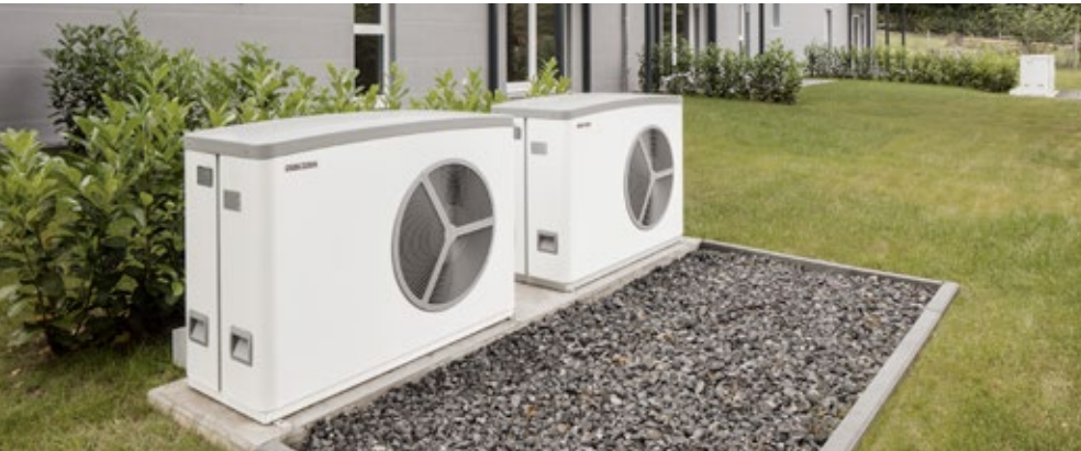
Die außenaufgestellte Luft-Wasser-Wärmepumpenkaskade sorgt klimafreundlich für Wärme und Warmwasser im Gebäude.
