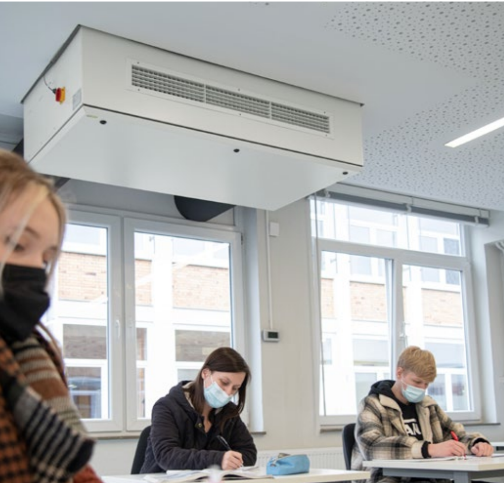
Dank des Lüftungsgerätes können die Schülerinnen und Schüler konzentriert und störungsfrei lernen – ohne dass alle 20 Minuten der Unterricht für das Fensteröffnen unterbrochen werden muss.
