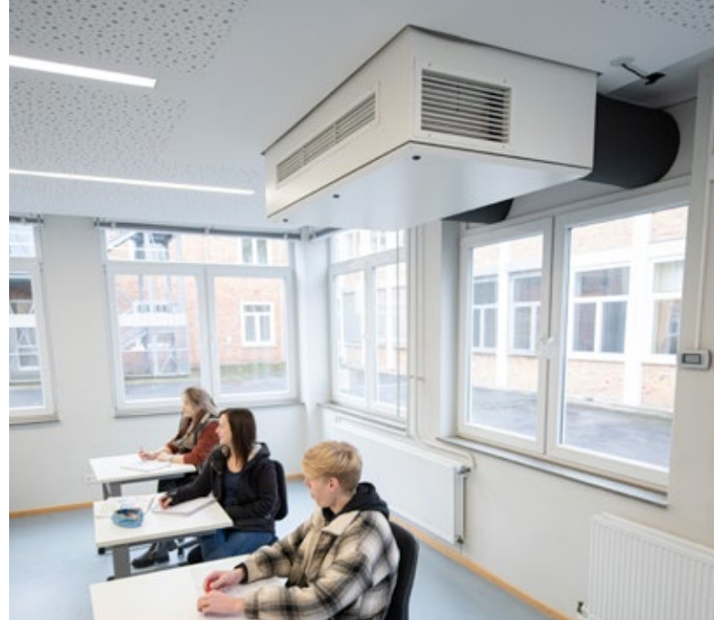
Die Schüler können sich störungsfrei auf den Unterricht konzentrieren – das Lüftungsgerät läuft nahezu geräuschlos, und die Fenster müssen auch nicht geöffnet werden.
