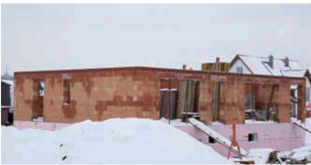
Abb. 1 Winterbaustelle mit starkem Feuchteintritt im Ziegelmauerwerk
