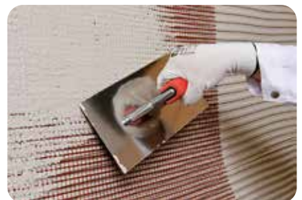
6. Nach einer Standzeit des Dämmputzes von 1 Tag pro cm Auftragsdicke muss bei einem Dünnschichtputz eine ca. 5 mm bis 8 mm dicke Armierungsschicht aus weber.therm 300 aufgebracht werden, in die das Armierungsgewebe weber.therm 310 eingebettet wird.
