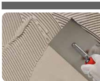
2. Auftragen der reaktivabdichtenden Abdichtung weber.tec Superflex D 24 oder der Flex Dichtschlämme weber.tec Superflex D 2 mit der Spitzzahnkelle. Anschließend wird die Fläche plangezogen.
