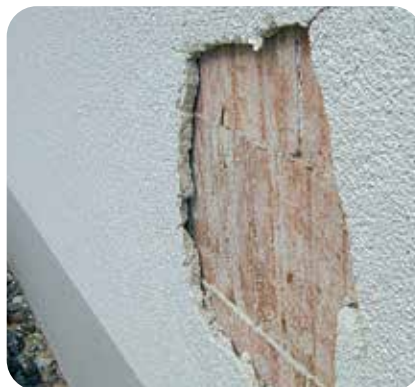
2. Schäden durch einen feuchten Putzgrund
