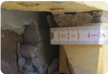
4. Sparverblender II ( d = 55 bis < 90 mm) im Mörtelbett auf tragfähigem Untergrund. Teilflächige Ablösung der Verblender von der Mörtelschicht/tragenden Wand
