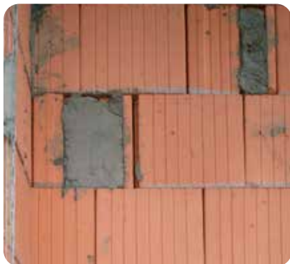
Mörteltaschen und Fehlstellen
