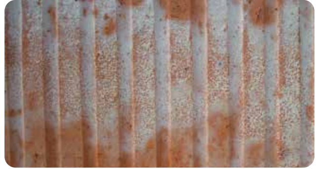
Ausblühungen – immer noch zu hohe Feuchte?
