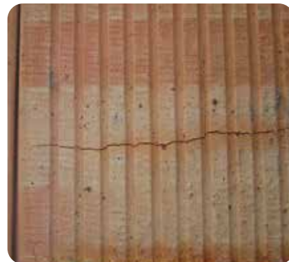
Riss im Ziegel
