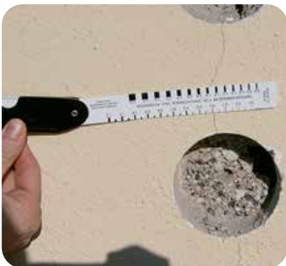
1. Riss aufgrund zu hoher Druckfestigkeit des Putzes
