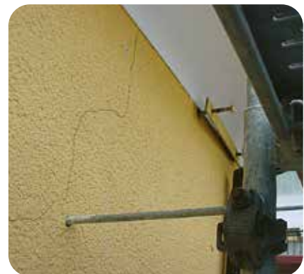
3. Riss aufgrund statischer Mängel des Leichtmauerwerks
