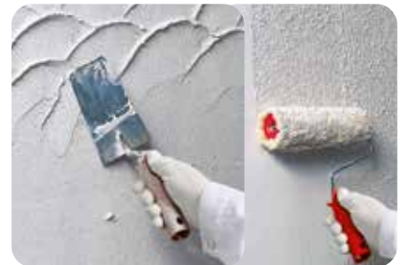
3. Freistrukturierbare Oberputze können mit verschiedenen Werkzeugen strukturiert werden, z.B. mit Kelle oder Strukturwalze .
