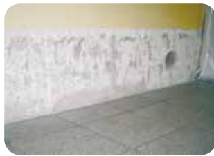
12. Schimmelpilze sind Oberflächenbesiedler. Putze mit hoher Alkalität, z.B. Kalk- und Kalkzementputze, sind schimmelhemmend und kein geeigneter Nährboden. Gesunde, festhaftende Putze müssen nicht entfernt werden. Hier ist in der Regel die oberflächige Entfernung des Befalls ausreichend.
