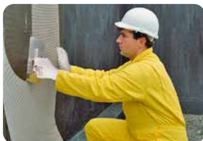
11. Ausführung einer Kratzspachtelung und der ersten Abdichtungslage auf den Betonfertigteilelementen aus weber.tec Superflex 10 unter Einarbeitung weber.sys 981 .
