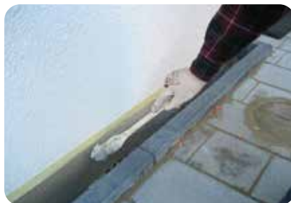
11. Herstellung des Feuchteschutzes des Sockelputzsystems. Der Kapillarverschluss aus weber.tec Superflex D 2/D 24 wird bis ca. 5 cm über Gelände ausgeführt. Die Abdichtungsschicht ist mit weber.ton Fassadenfarben, vorzugsweise mit Silikonharzfarben, weber.ton 411 AquaBalance , oder Silikatfarben, weber.ton 414 AquaBalance überstreichbar.
