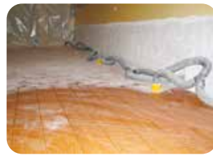
12. Nach der Ursachenbeseitigung, etwa Sanierung defekter Abdichtungen, und Entfernung des Schimmelbefalls, empfehlen wir eine komplette Feinreinigung der betroffenen Bereiche, mittels sogenanntem Hepa-Staubsauger. Dadurch werden Schimmelpilzsporen von den Oberflächen entfernt.
