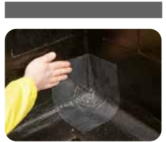
4. Ausbildung des Details Innenecke. Das Formstück wird aus der Rollenware entsprechend zugeschnitten und eingeklebt.
