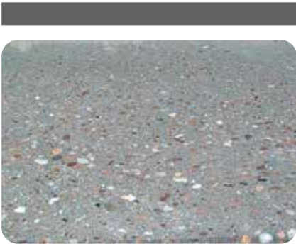
1. Der Untergrund muss sauber und tragfähig sein. Alle haftungsmindernden Bestandteile sind von der Oberfläche der Reparaturstelle vollständig zu entfernen.
