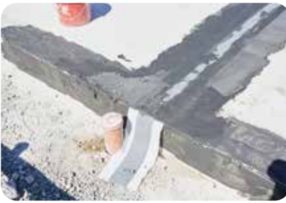
7. Bandende über die Fuge hinausstellen lassen, schützen und später in die aufgehende Wandabdichtung einarbeiten.
