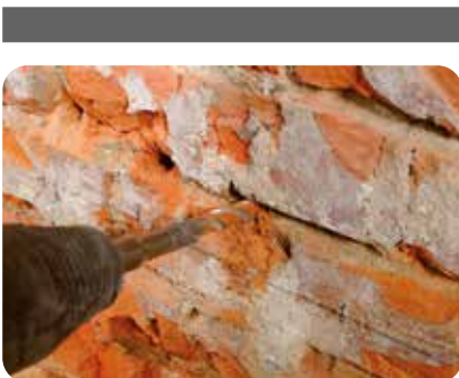
4. Für das Einbringen der Horizontalsperre werden horizontal Löcher in die Lagerfuge gebohrt. Durchmesser: 16 mm, Tiefe: Mauerwerksdicke minus 5 cm, Abstand: 8–12 cm. Die Anordnung der Bohrlochkette erfolgt möglichst unmittelbar unterhalb der Kellerdecke.
