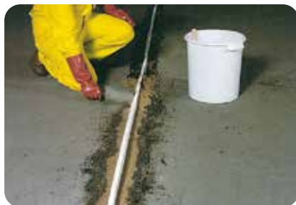
8. Die Sanierung der Fugenflanken wird mit dem 2-komp. Universal-Bauharz weber.tec 793 Epoxidharzmörtel, Bindemittel und Haftbrücke, ausgeführt.
