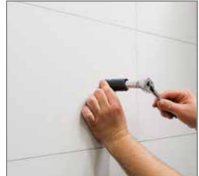
Anschlussstück an der Wand montieren.
