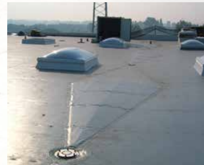
Punktentwässerung entlang der Kehllinien
