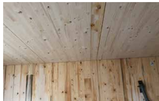
Unschöne Wasserflecken an einer Brettsperrholzdecke
