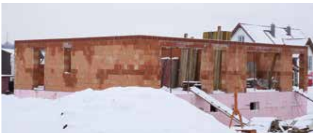
Abb. 1 Winterbaustelle mit starkem Feuchteintritt im Ziegelmauerwerk
