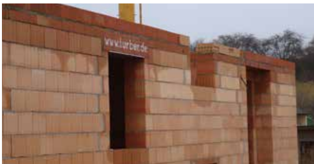
Abb.3 Winterbaustelle mit starkem Feuchteintritt im Ziegelmauerwerk
