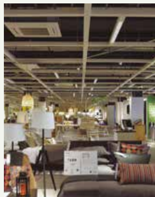
Neues „Click & Collect“-Einrichtungshaus von IKEA im Stadtzentrum. Birmingham, Großbritannien. ECOi und ECO G
