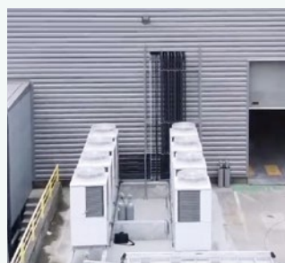
STEMCELL Technologies, ein global agierendes Biotechnologieunternehmen, nutzt CO 2 -Verflüssigungssätze in seinen Kühltälern, Frankreich. Kältetechnik
