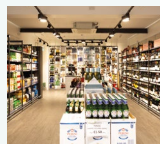
Installation von Panasonic CO 2 -Verflüssigungssätzen bei Modernisierung des Supermarkts Nolan's in Irland. Kältetechnik
