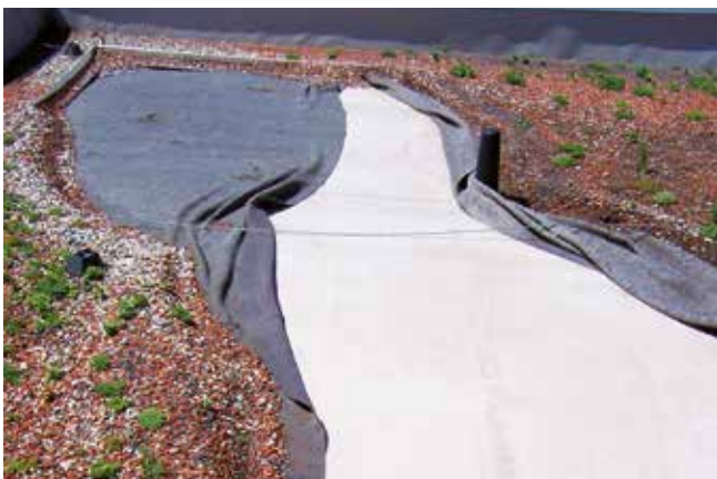
▲ Verwehungen, die in diesem Fall bis auf die Dachabdichtung gehen
