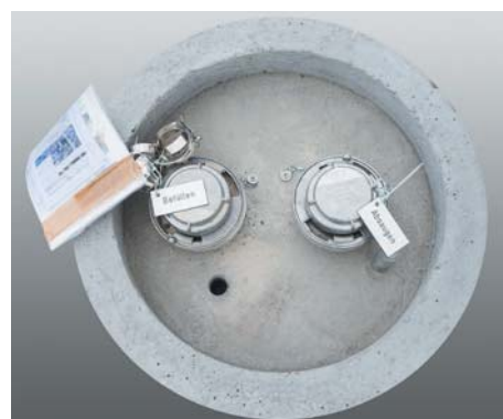
Füll- und Absaugstutzen Pelletspeicher
