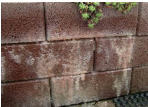
Ausblühungen an Blähtonsteinen
