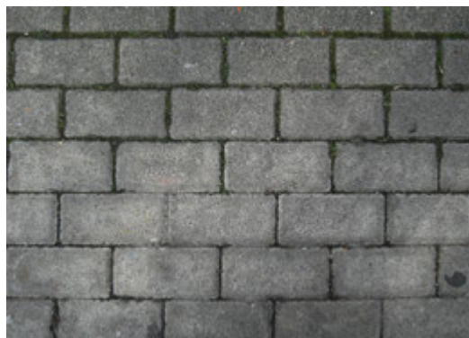
Ausblühungen auf Pflastersteinen
