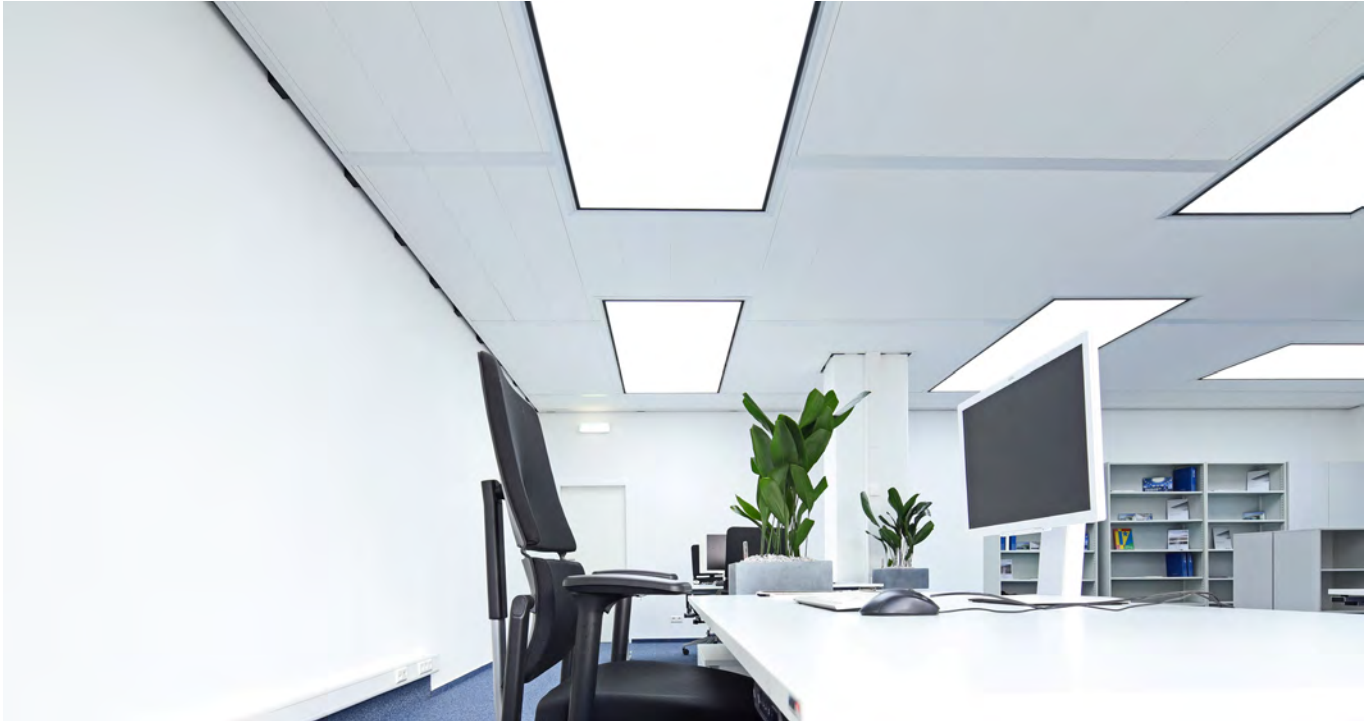
▲ INDUSAIL LUMINOUS in einem Großraumbüro deckenbündig integriert.
