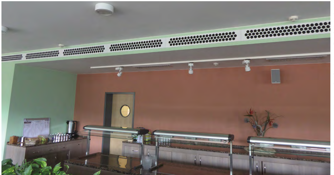
INDUQUELL – Evangelisches Allianzhaus, Bad Blankenburg. Foto © Kiefer GmbH
