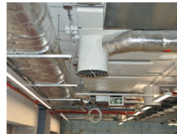
▲ Kiefer realisierte einen doppelwandig isolierten Luftanschlusskasten mit zweischaligem Anschlussstutzen, komplett beschichtet in RAL 9010.
