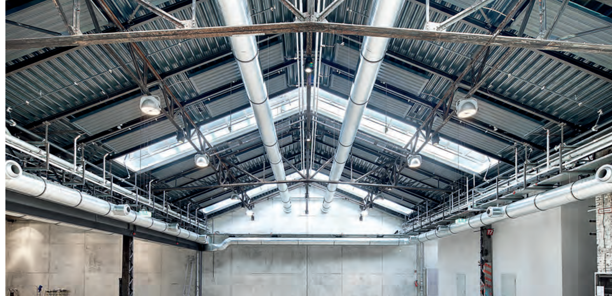
▲ Alle Komfortbereiche werden über ein Kanalnetz aus verzinkten Blechkanälen und Wickelfalzrohren be- und entlüftet. Sie erfüllen höchste Anforderungen beim Schall- und Brandschutz.
