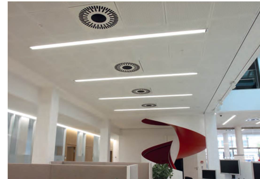
▲ Neubau des Kundenhauses in Bayreuth mit Integration der Umluftkühlgeräte INDULVENT ec als bündig und ohne Werkzeug abklappbare Frontplatte im Deckensystem.
