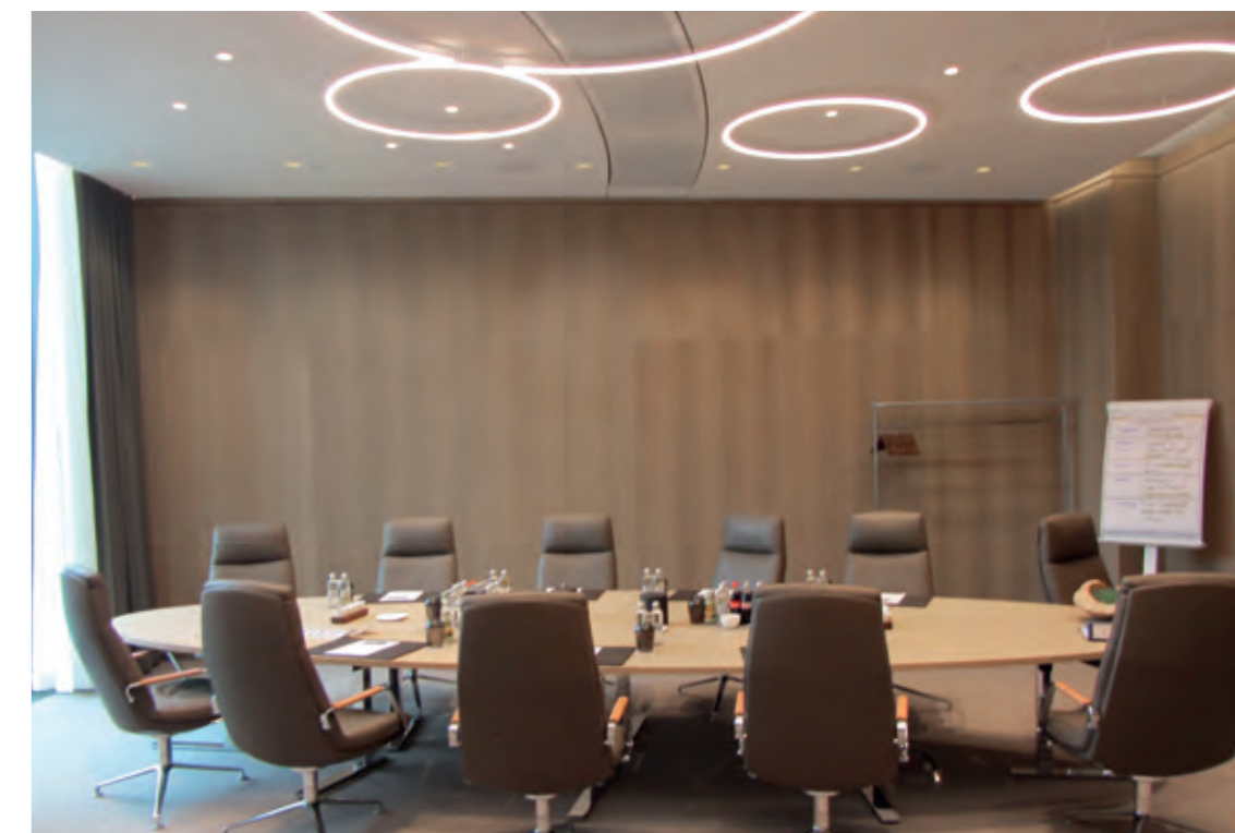
▲ Maßgeschneiderte Lösung für die Besprechungsräume: Die Quelldurchlässe INDUQUELL DIV wurden entsprechend der Außengeometrie des jeweiligen Raumes in einer geschwungenen, organischen Linie in die Decke eingesetzt. Foto © Kiefer GmbH
