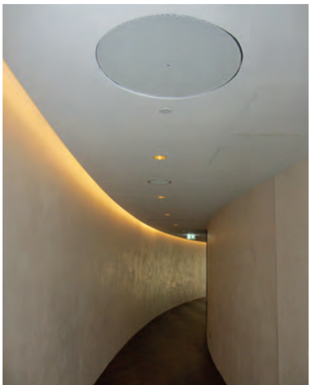
▲ In den Fluren, Durchgängen, Shops und in der Bibliothek ist der Decken-Luftdurchlass INDULCLIP mit einer speziellen Lochblechüberdeckung ausgestattet.
