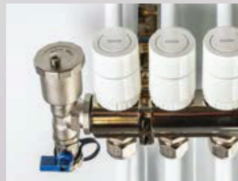
Das Raumthermostat steuert auch Stellantriebe (230 Volt), die im Heizkreisverteiler montiert sind.
