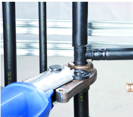
Abbildung 30: Sanitäreinheiten sind mit Versorgungs- und Entsorgungsleitungen ausgerüstet, sodass diese nur noch mit den Gebäudeleitungen verbunden werden müssen.
