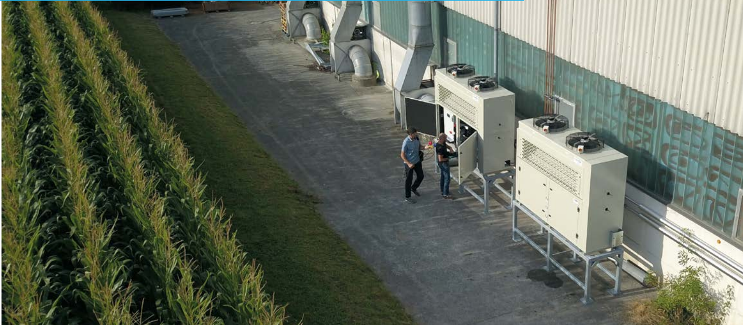
Projekt: Tiefkühlager in Hendschiken (CH); zwei Maschinen (HCU1D30) mit insgesamt 60 kW, installiert im September 2021
