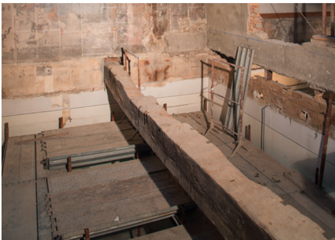
Holzbalkendecken müssen zum Trocknen komplett freigelegt werden.
